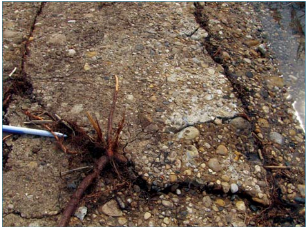
Figure 1.1. Dégradation d'une dalle béton par des racines d'arbuste ayant colonisé une fissure (ph. C. Zanetti).
